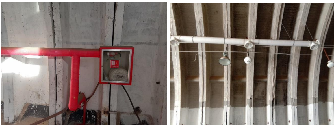
Зураг 4. Агуулахын доторх галын гидрант болон агааржуулалт, гэрэлтүүлгийн холболтууд
