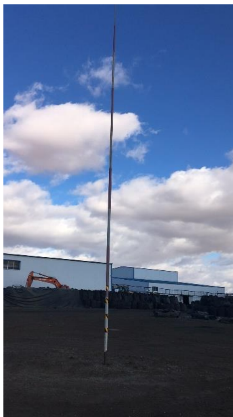
Зураг № 23 Аянга зайлуулагч байршуулсан байдал
