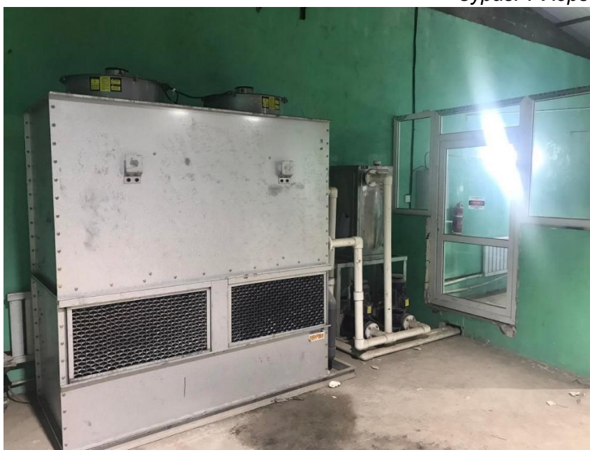
Зураг. 7 Хөргөх төхөөрөмж
