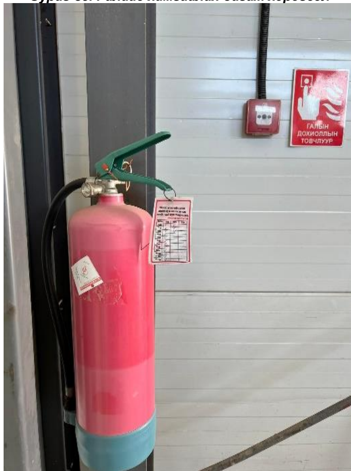
Зураг 40. Үйлдвэр, агуулахад галын хорыг байршуулсан байдал
