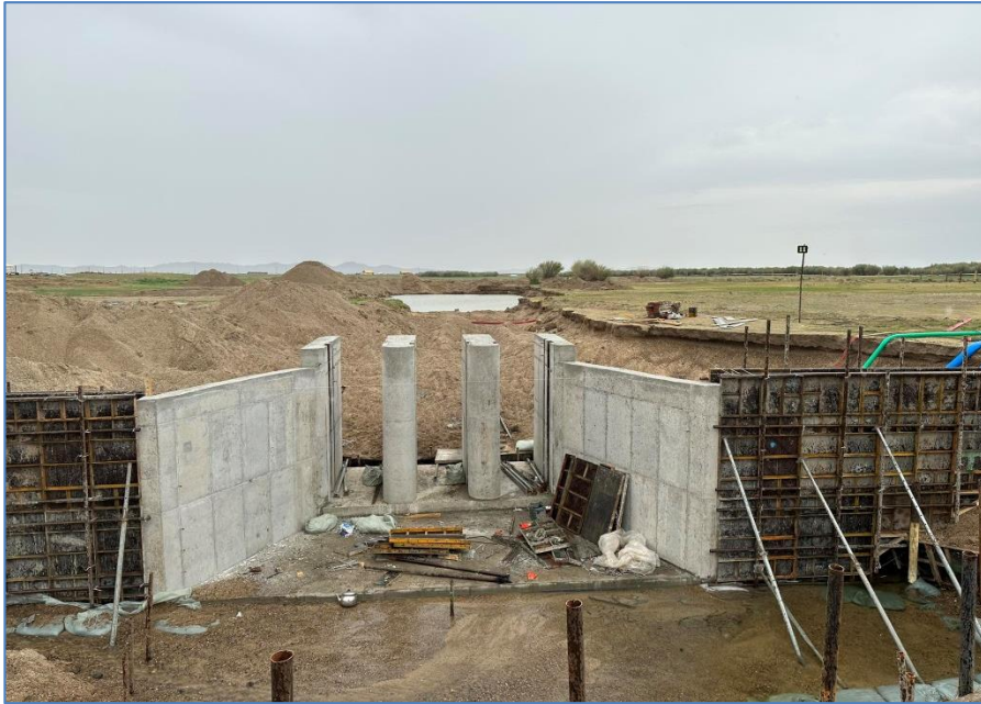
Зураг 17. Толгойн барилгын ус тосох цутгамал төмөр бетон далавч, далбааны арматурчилал хэв угсралт
