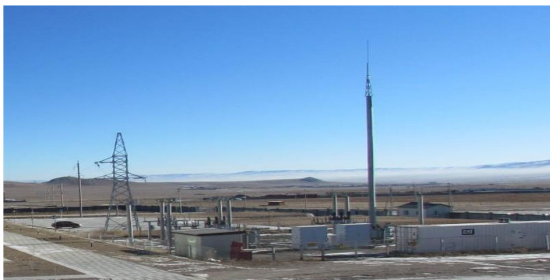
Зураг 3: Цахилгааны 35/0,4 кВ-ын дэд станц
