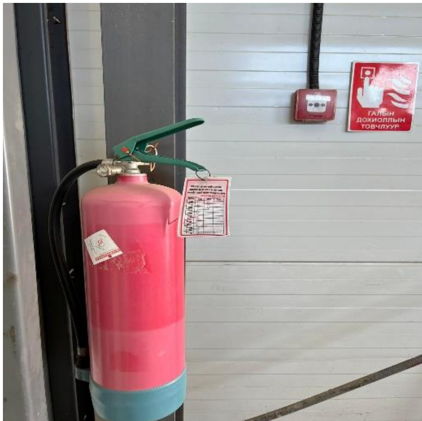
Зураг 17. Үйлдвэр, агуулахад галын хорыг байршуулсан байдал
