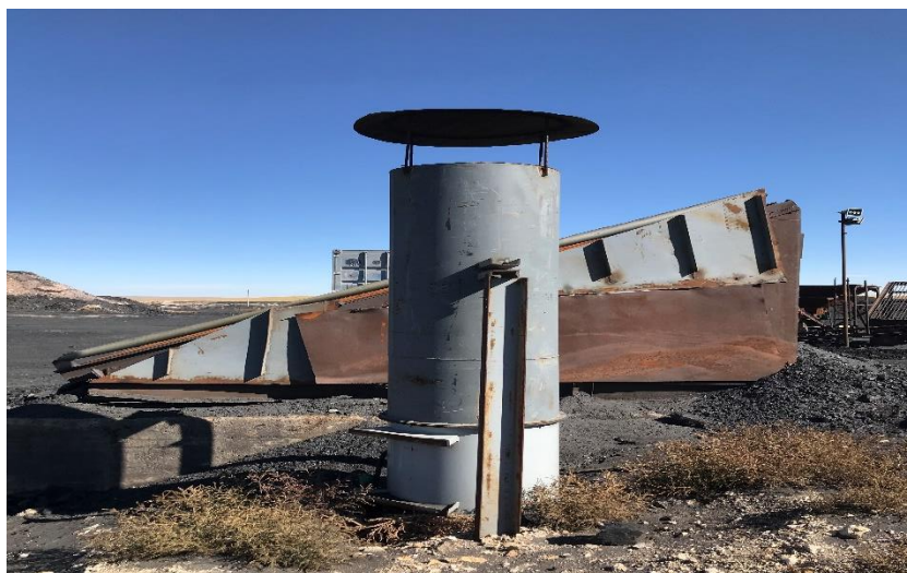
Шигшүүрээс бутлуур руу орох хэсэгт суурилуулсан тоос гадагшлуулагч
