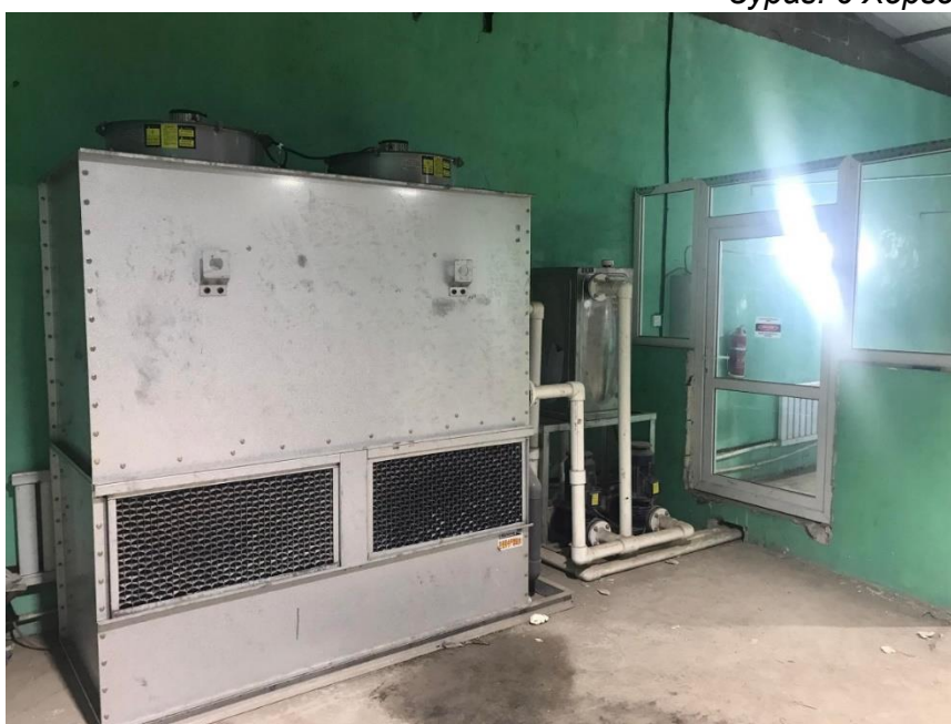
Зураг. 6 Хөргөх төхөөрөмж
