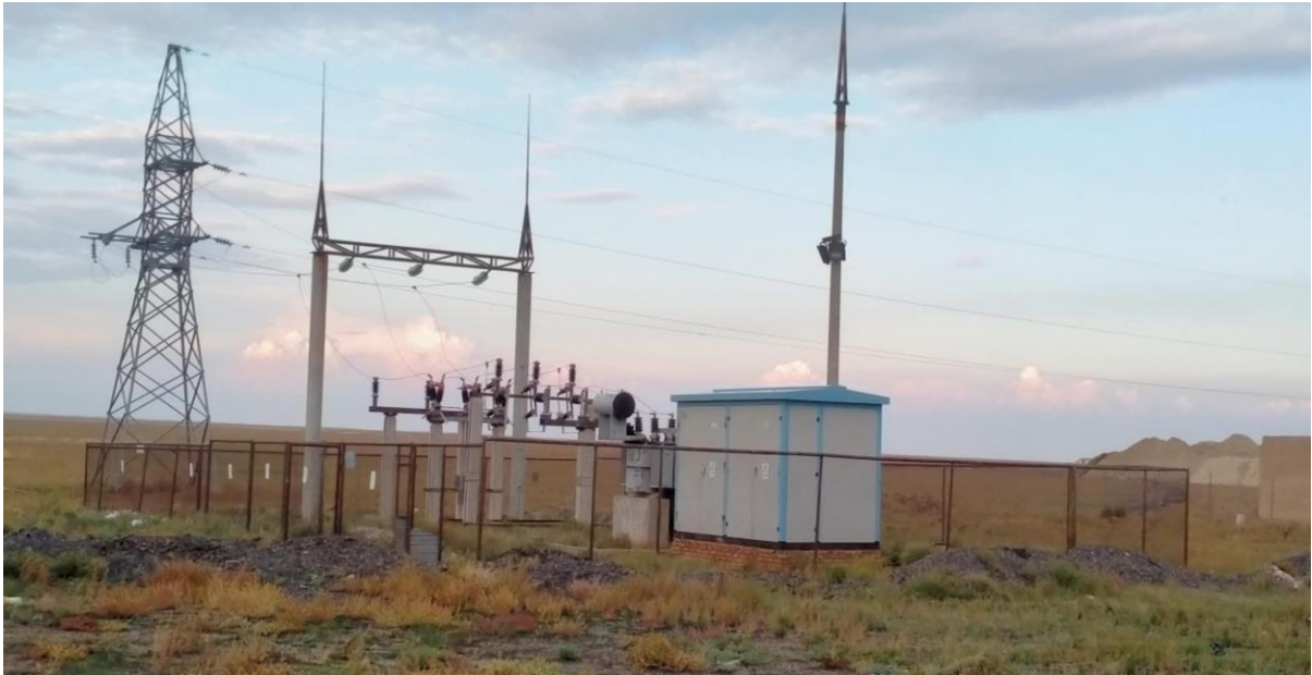
Зураг №3. Үйлдвэрийг ЦЭХ-ээр хангах 35/0.4 кВ-ын дэд станц
