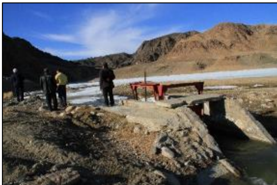
Зураг 2.2019 онд Толгойн барилгын хаалтны засвар хийгдэхээс өмнөх үе
