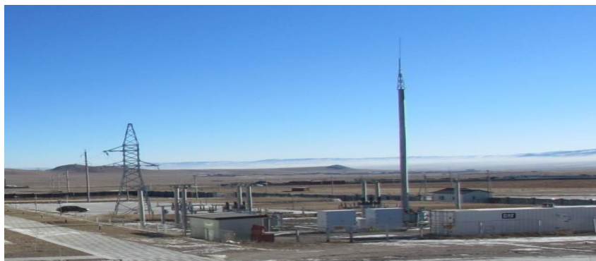
Зураг 3: Цахилгааны 35/0,4 кВ-ын дэд станц
