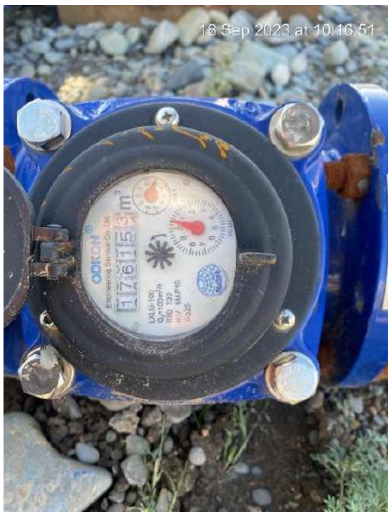
Насос станц №2 байршилд суурилуулсан тоолуур
