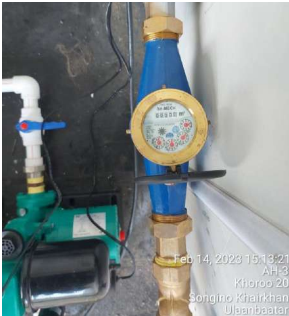
Усны насос болон тоолуур суурилуулсан байдал
