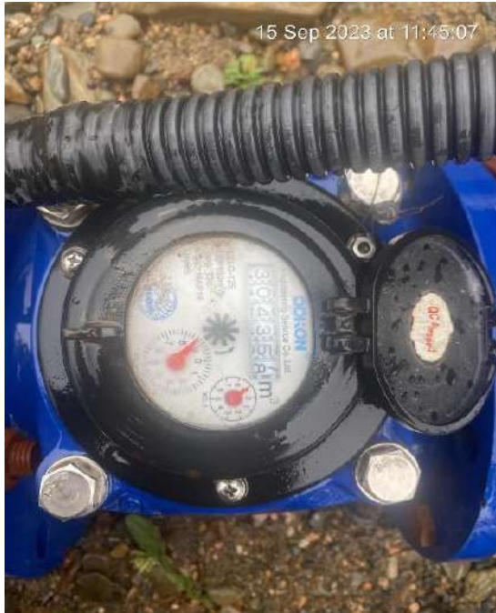
Насос станц №1 байршилд суурилуулсан тоолуур
