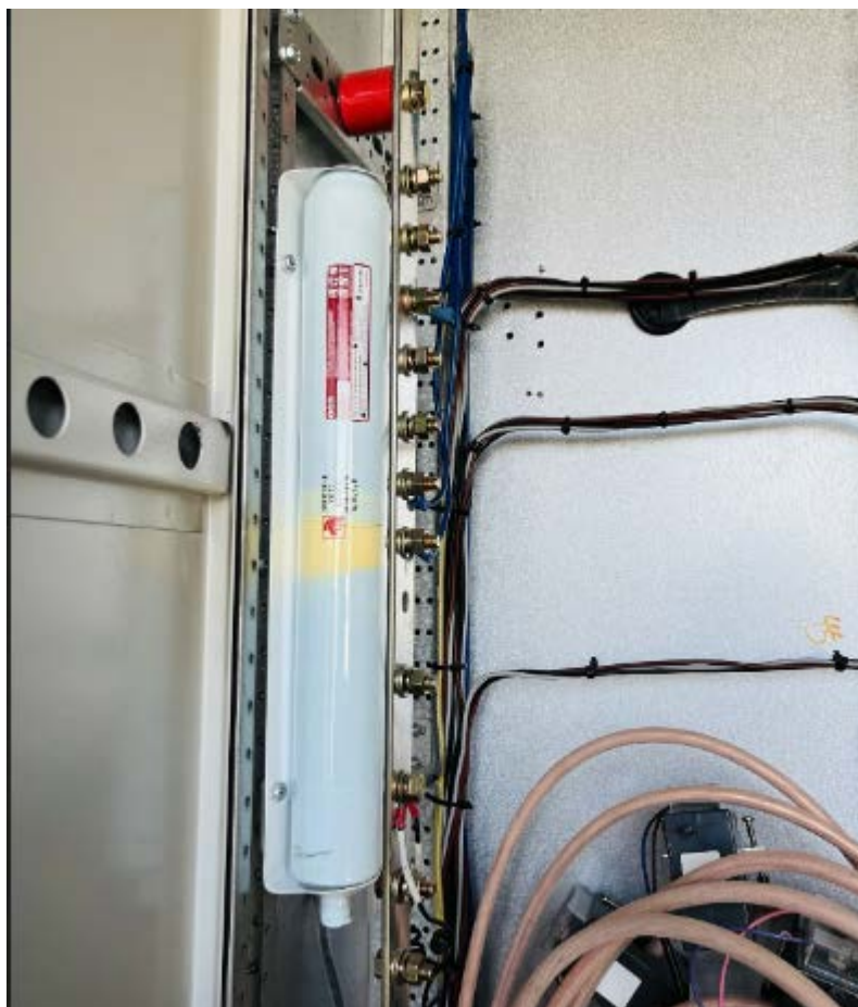
Зураг 3.2. 2023 оны 10-р сарын 01-ний өдөр цахилгааны өрөөний хуваарилах самбаруудад автомат гал унтраагуур суурилуулсан байдал
