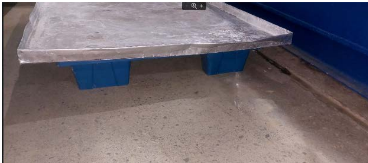
Зураг 3.4. Химийн бодис хүлээн авах болон Үйлдвэрлэлд химийн бодис нэмэх үеийн химийн бодисын хоёрдогч контейнер буюу асгаралтаас сэргийлэх тосгуур байршуулсан байдал
