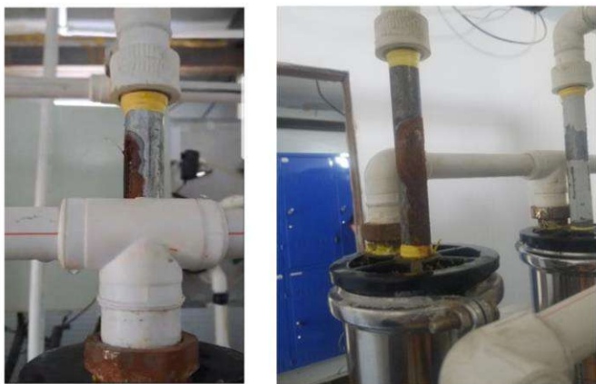
Ажилчдын амрах хотхоны ус цэвэршүүлэх төхөөрөмжийн цоорсон хоолойг солив.
