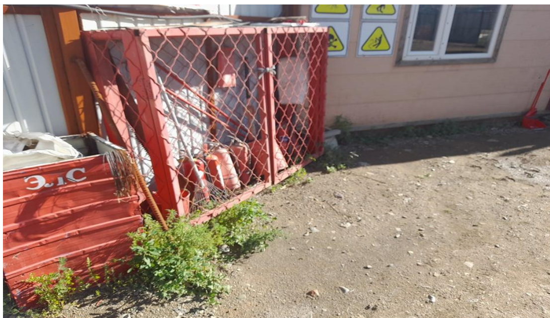
Зураг-8.5. Төслийн талбайд гал унтраах хэрэгсэл байршуулсан байдал /галын сараа, гал унтраагуур/
