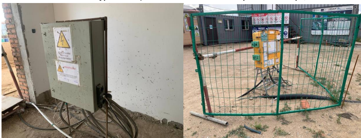
Зураг-8.6. Цахилгааны тоног төхөөрөмжийг хайрцагласан байдал.
