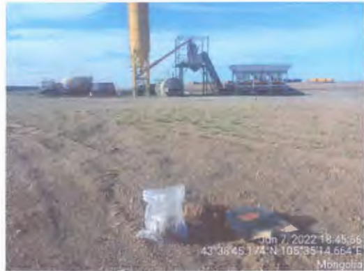
Зураг 7.14. Цэг 10 Бетон зуурмагийн үйлдвэр
