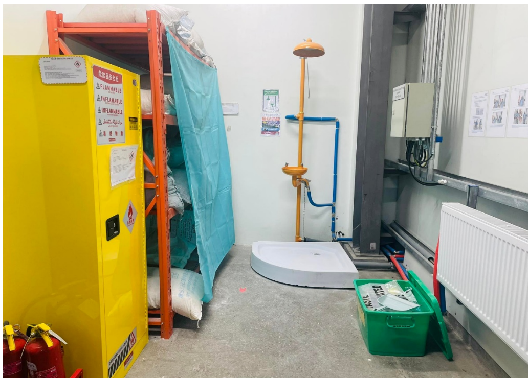
Зураг 3.15. Химийн бодисын агуулах болон хийн аж ахуйн зааланд нүд угаах төхөөрөмж болон шүршүүр суурилуулсан байдал.
