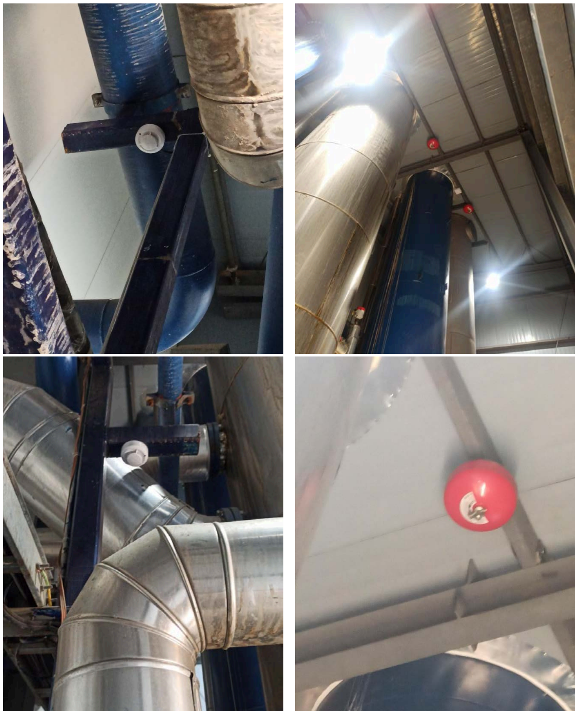
Зураг 5.7. Өргөтгөлийн барилгад галын дохиолол, утаа мэдрэгч, автомат гал унраагуур суурилуулсан байдал.
