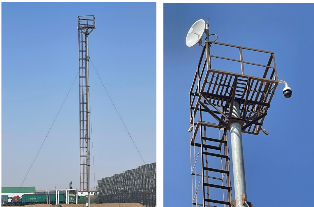
Зураг 6. 20 метр өндөртэй 2 ширхэг суурилуулсан гэрэлтүүлэг, камер бүхий Мобинетийн антен
