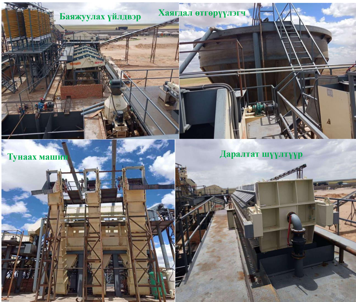
Зураг 4. Нүүрс баяжуулах үйлдвэрийн угсарсан байдал
