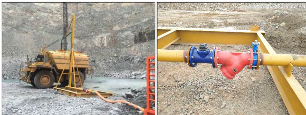
Зураг 2-22. Машинд ус ачих төхөөрөмжийн зураг болон усны тоолуур суурилуулсан байдал
