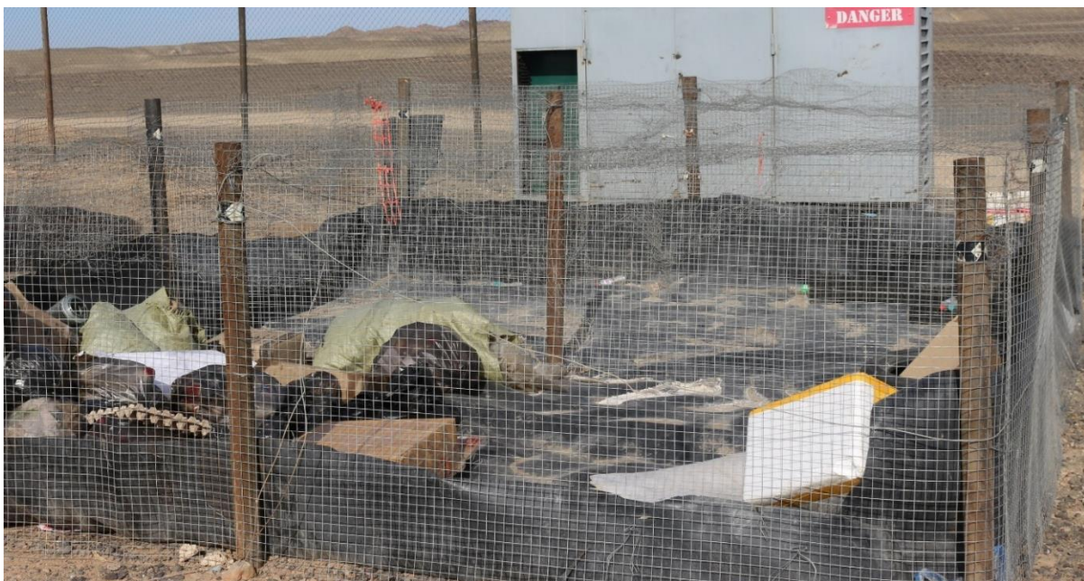
Зураг 21. Хөрсөнд үзүүлэх нөлөөллийг бууруулах үүднээс үл нэвчүүлэх пилонкийг хогийн цэгийн доор дэвссэн байдал
