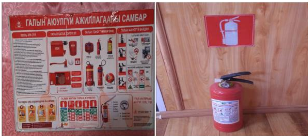
Зураг 50. Галын аюулгүй байдлын самбар, хор байршуулсан байдал
