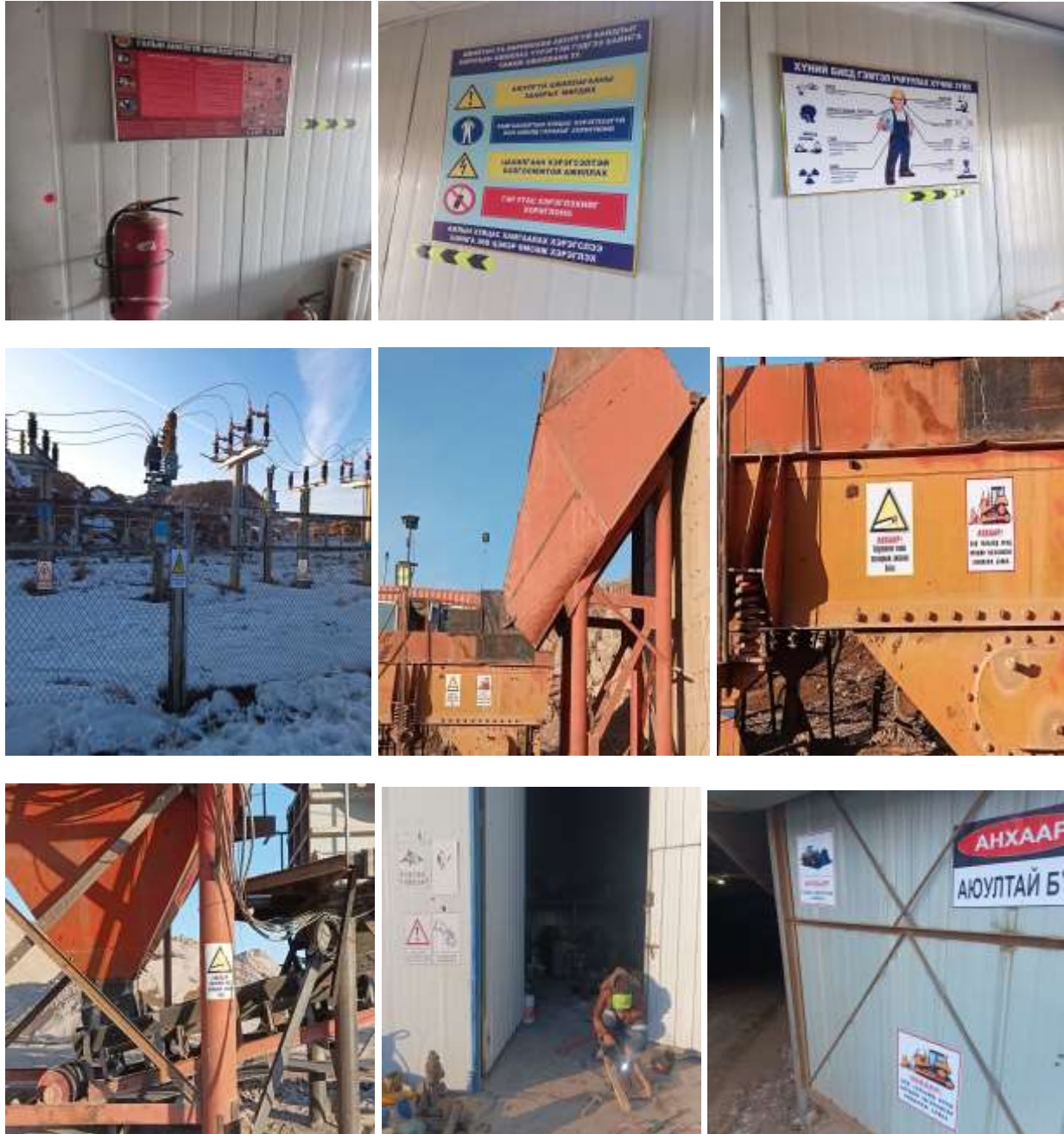
Зураг 17. ХАБ-н тэмдэг тэмдэглэгээ байршуулсан байдал
