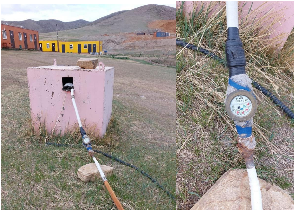
Зураг 17 Уст цэгт байрлуулсан тоолуур
