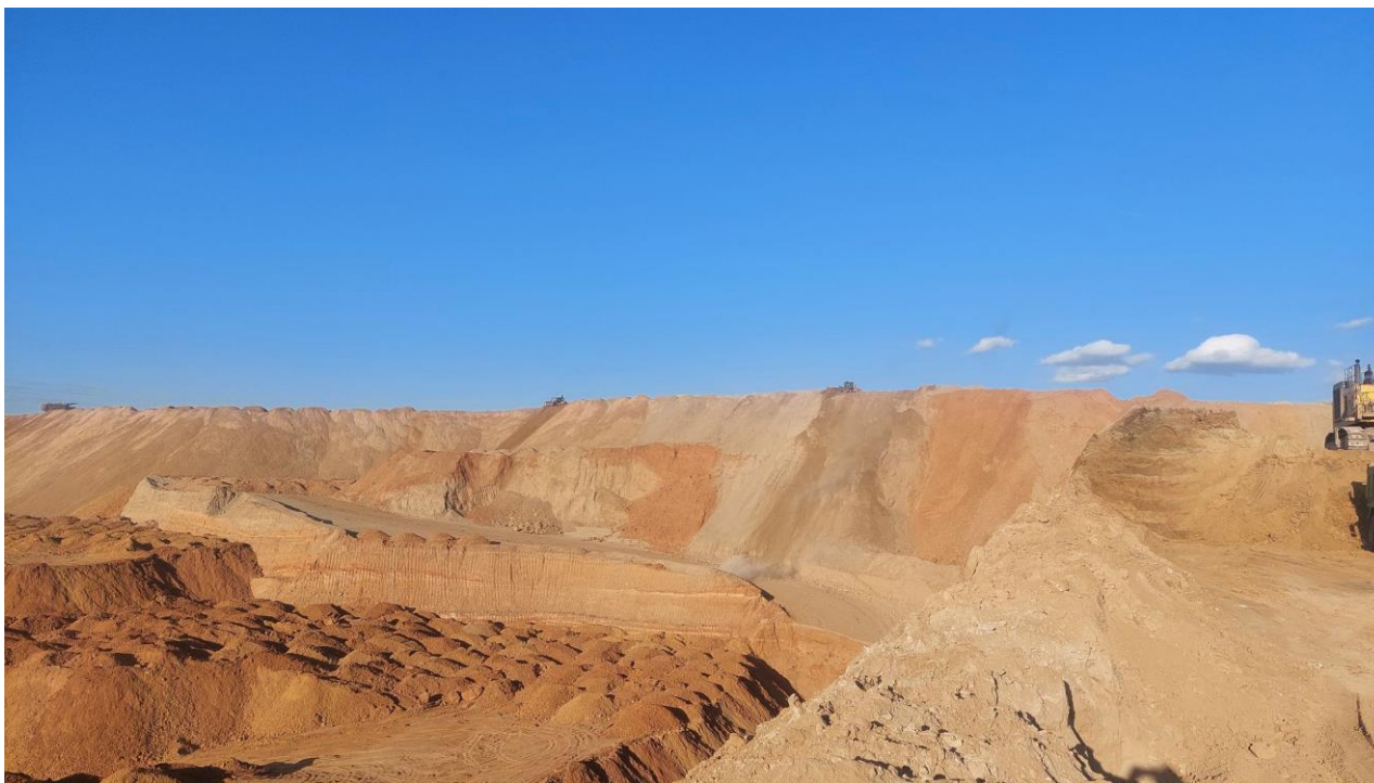
Зураг 24 Ухиийг дүүргэх, хурдас чулуулгийн овоолгыг намсгах, ирмэгийг налуулах, тэгшлэх, хэлбэршүүлэлтийн ажил явагдаж байна.
