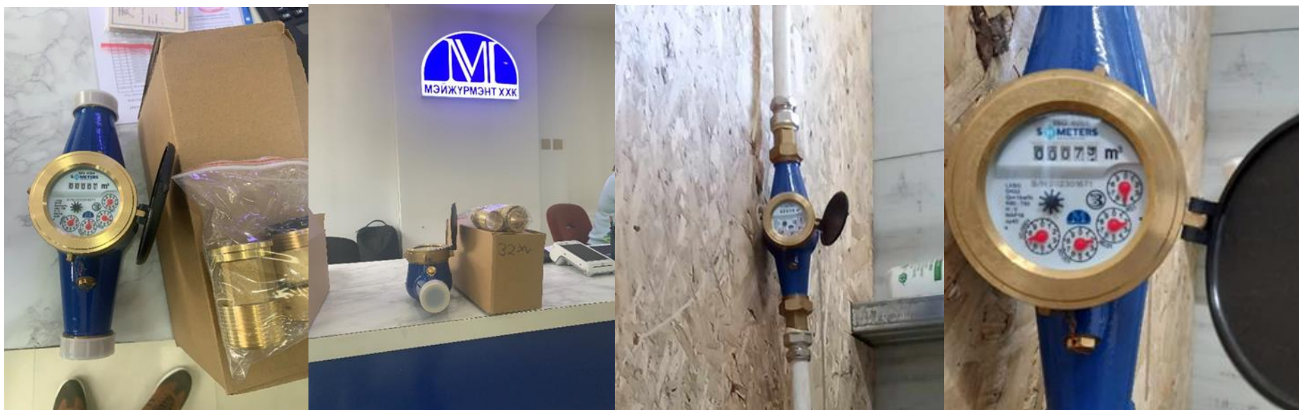
Зураг 13. Худгийн усны тоолуурыг суурьлуулсан байдал
