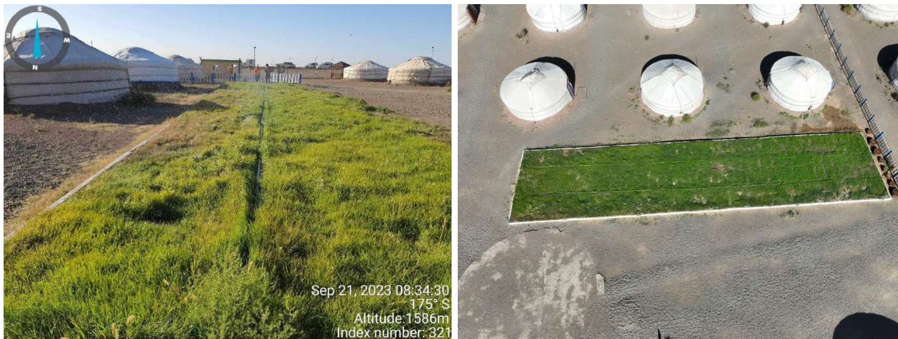
Зураг 15. Уурхайн хотхоны орчинг сайжруулах зорилгоор намираа усалгаа ашиглаж зүлэгжүүлэлтын ажлыг хийв.
