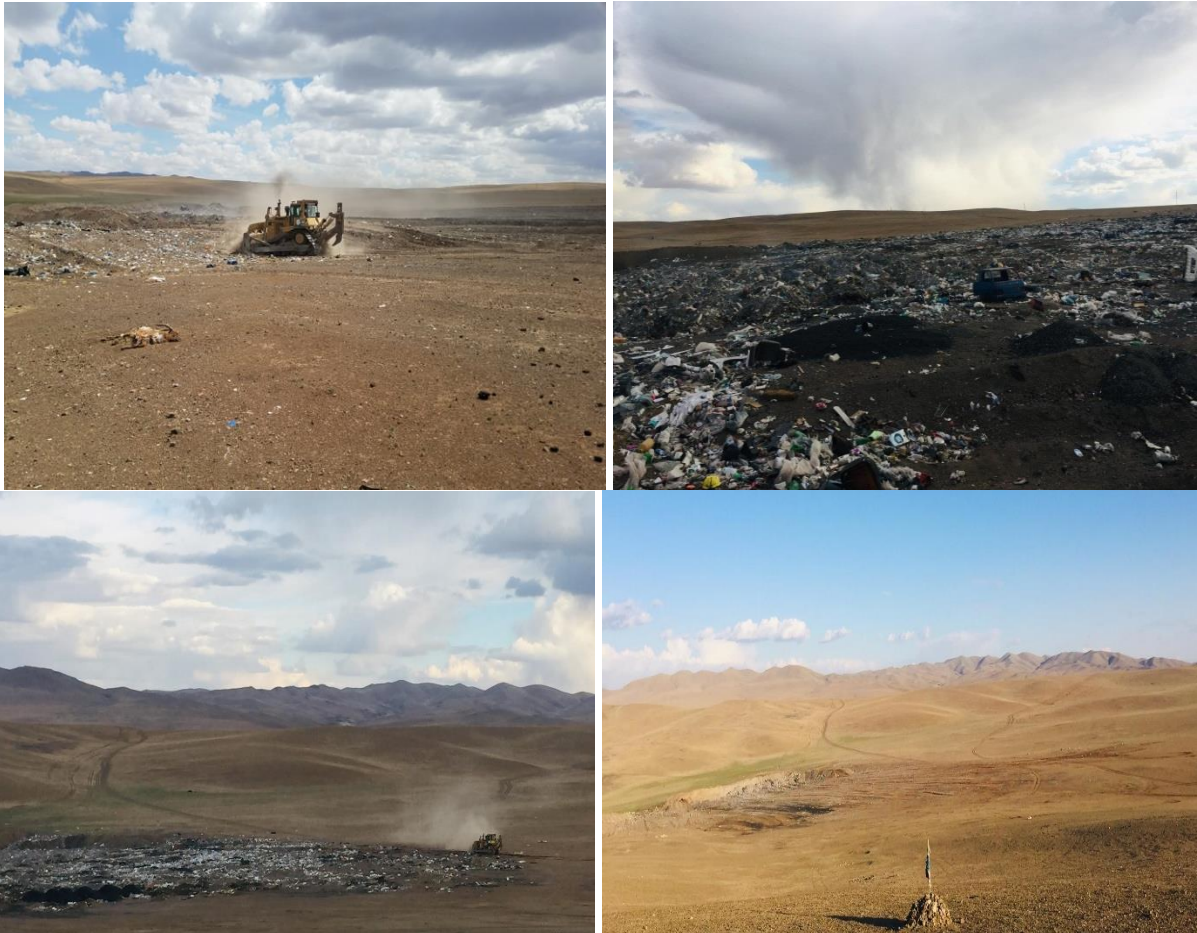
Зураг 32. Өвөрхангай аймгийн Уянга сумын нэгдсэн хогийн цэгийн хогийг түрэх, нягтруулах, булах ажлыг хийж гүйцэтгэсэн.
