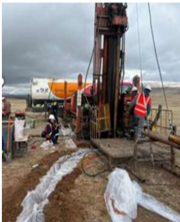
Зураг 3 Өрөмдлөгийн машин доор пластик уут дэвсэж хөрсөнд тос, тосолгооны материал нэвчихээс сэргийлсэн.
