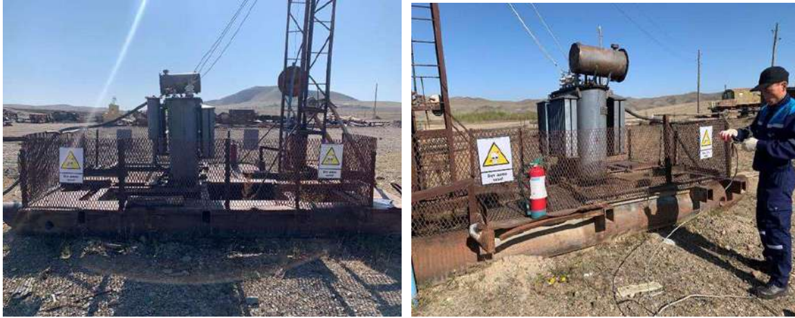
Зураг 34. Засварын талбайн өндөр хүчдэлийн трансформаторын гадна талын торон хашаанд ХАБ-ын шаардлагын дагуу АНХААРУУЛАХ ПЛАКАД -нуудыг дөрвөн талд нь байршуулж, цахилгаан хүчдэлд нэрвэгдэх эрсдэлийг бууруулж ажилласан.
