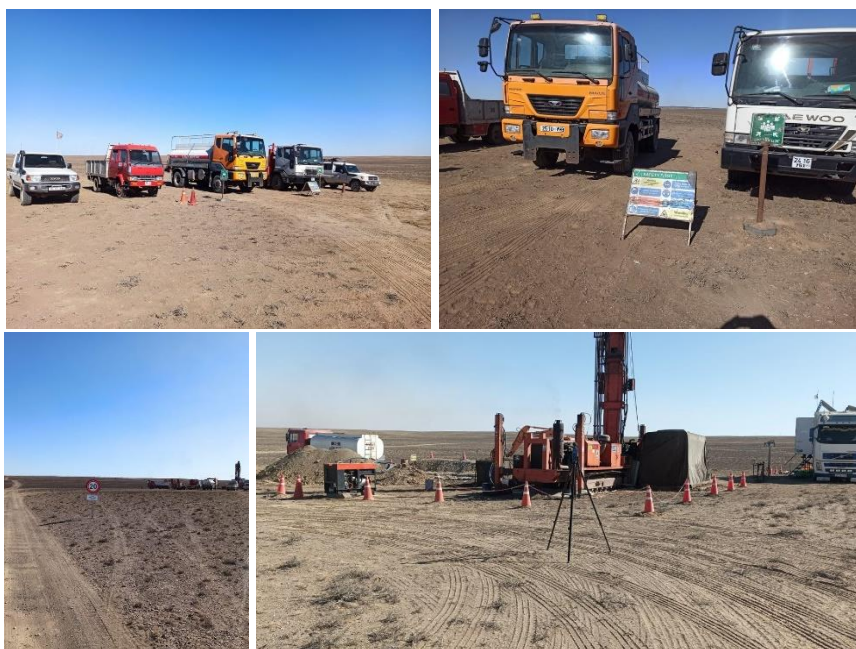
Зураг 17. Өрөмдлөгийн талбайн аюулгүйн зурвас, авто зогсоолын зохион байгуулалт болон мэдээллийн самбар, тээврийн хэрэгслийн хурдны хязгаарын тэмдэг байрлуулсан байдал
