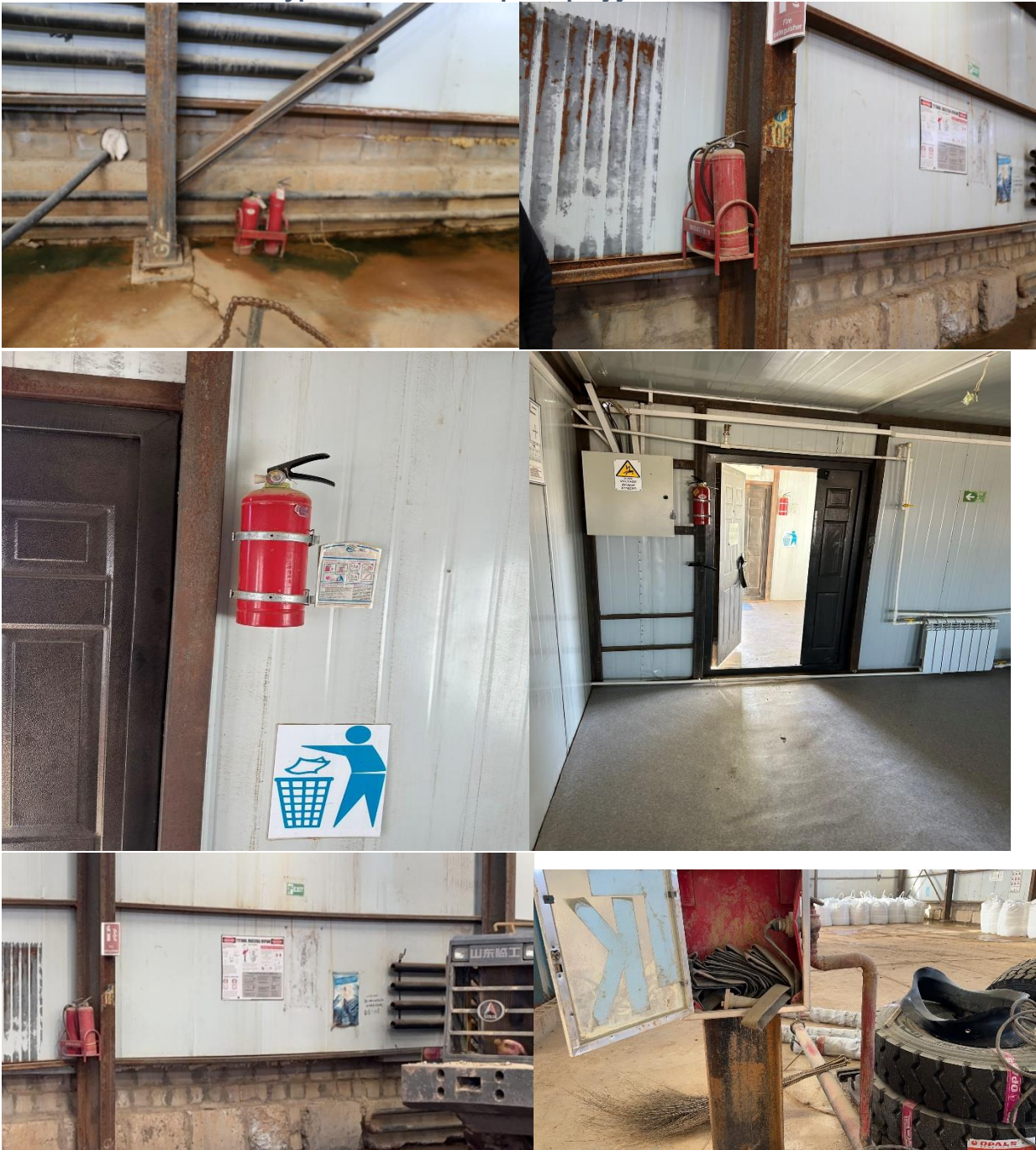
Зураг 14. Галын хор байршуулсан байдал
