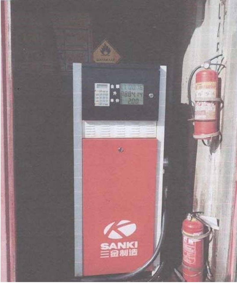
Зураг 20. ШТС-ын талбайд байрлуулсан гал унтраагуур
