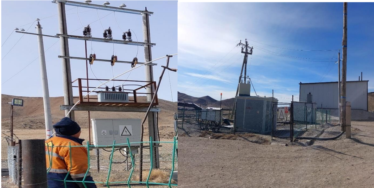
Зураг 17. Дэд станц
