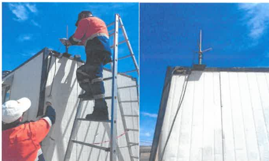
Зураг 24. Үндсэн лабораторид аянга зайлуулагч суурьлуулсан байдал
