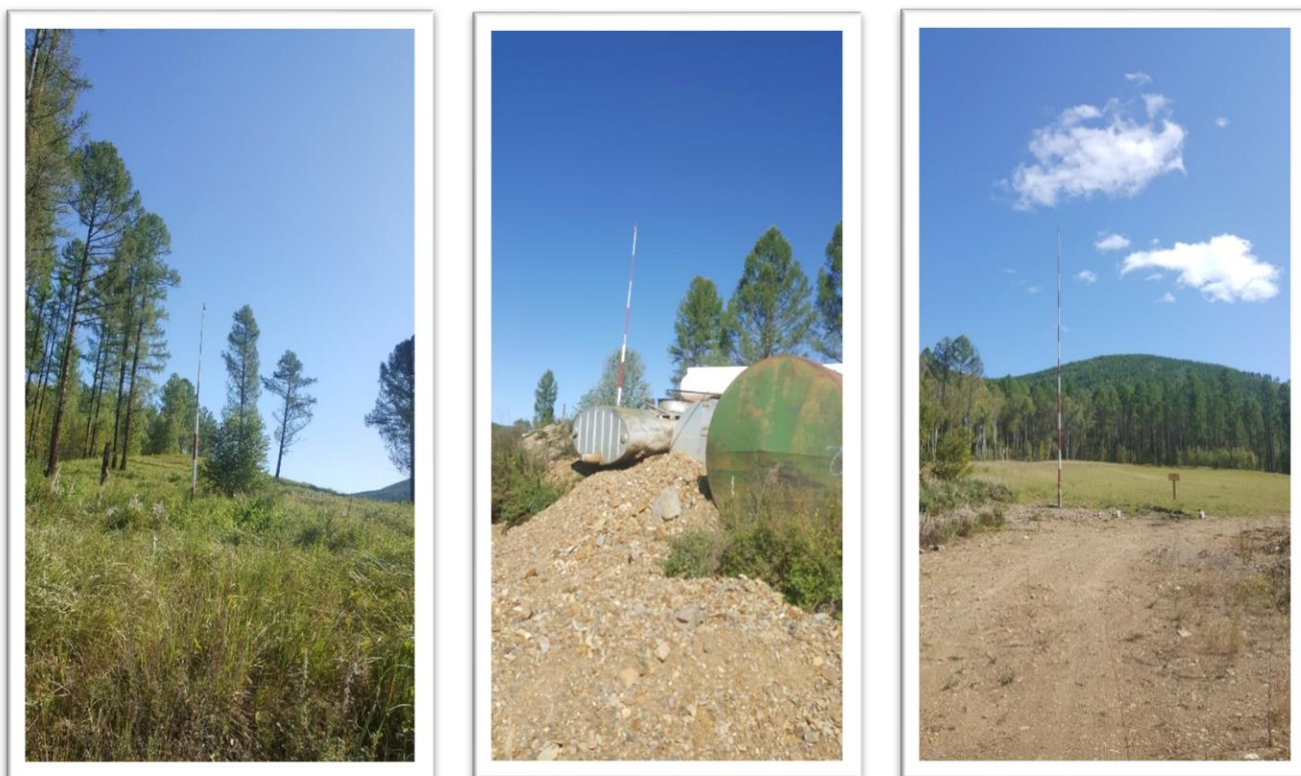
(Зураг № 18 Аянга зайлуулагч суурьлуулсан байдал А. Уурхайн тосгон Б. ШТМ-н агуулах В. Засварын талбай)
