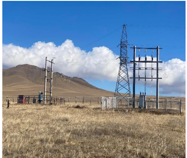
Зураг: 10 35/04 шугамын дэд станц, Дизель генератор нэмэлтээр суурилуулж ашиглахаар ажиллаж байна
