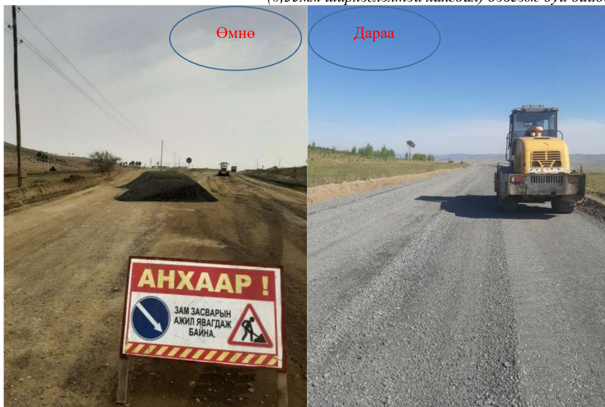
Зураг-2.1. Замд тоосжилт бага үүсгэдэг материал (0,35мм ширхэглэлтэй хаягдал) дэвсэж буй байдал.
