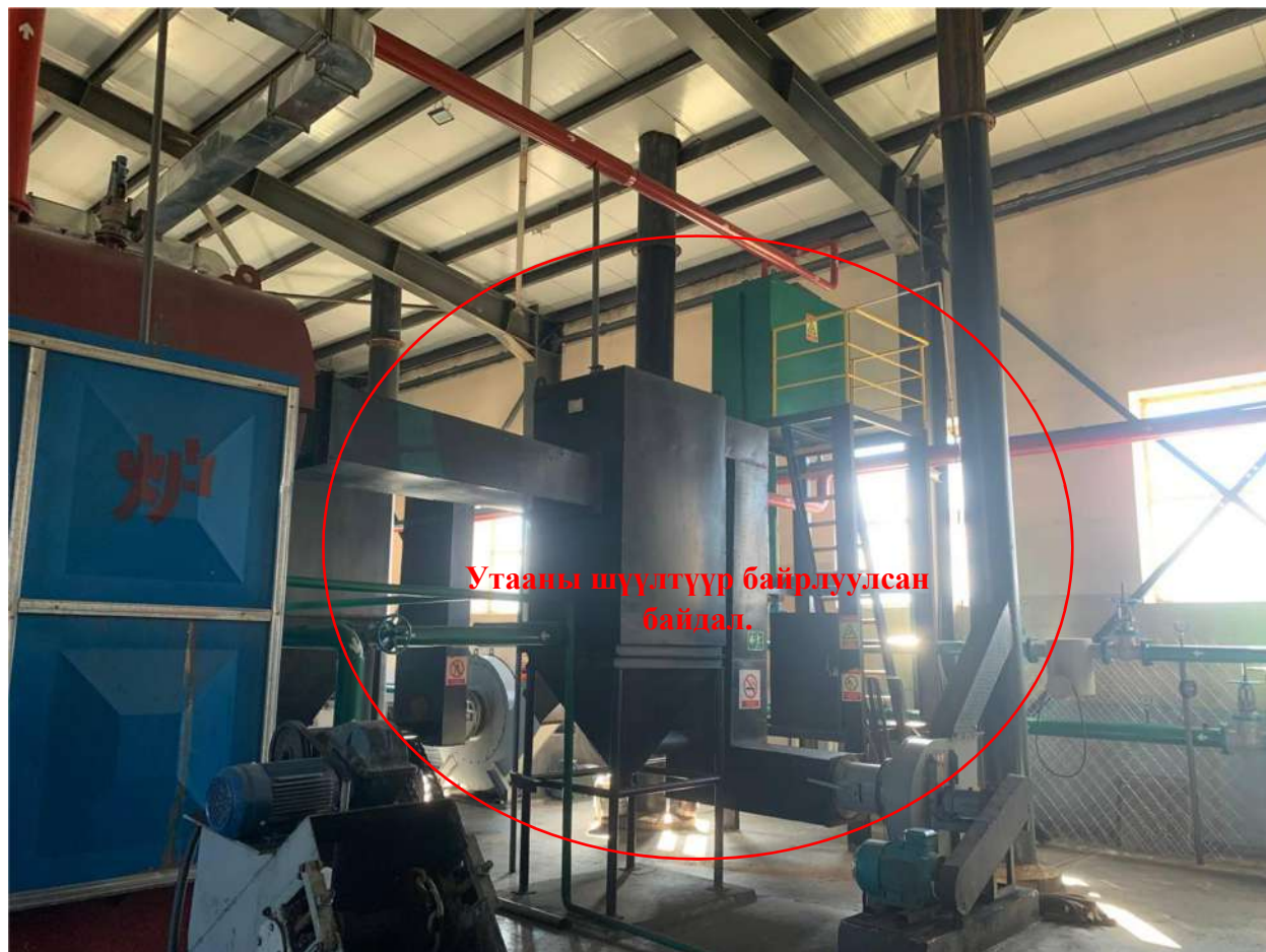
Зураг-2.7. Утааны яндангуудад утаа тоос шүүлч байрлуулсан байдал.
