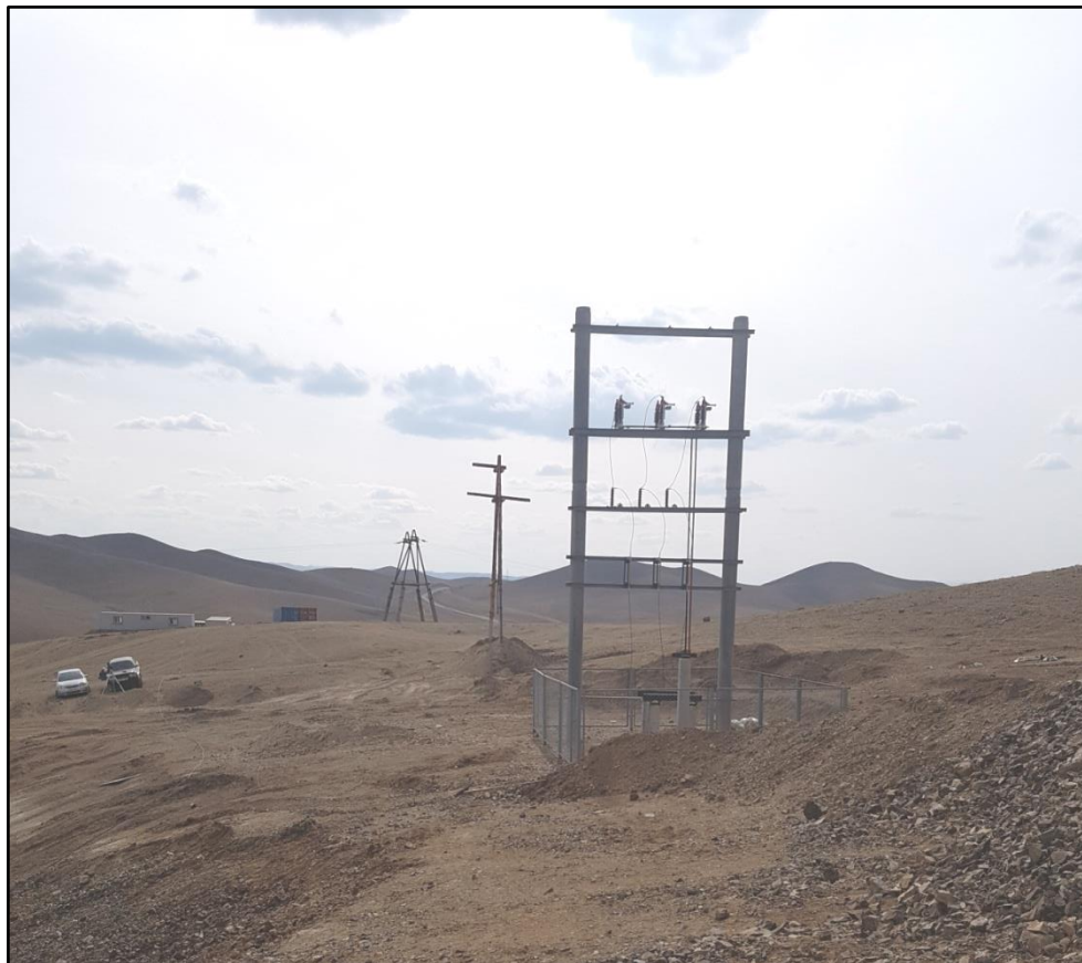
Зураг 3. Төслийн цахилгаан хангамж 800кВА чадал бүхий 35/0.4 кВ-ын трансформатор
