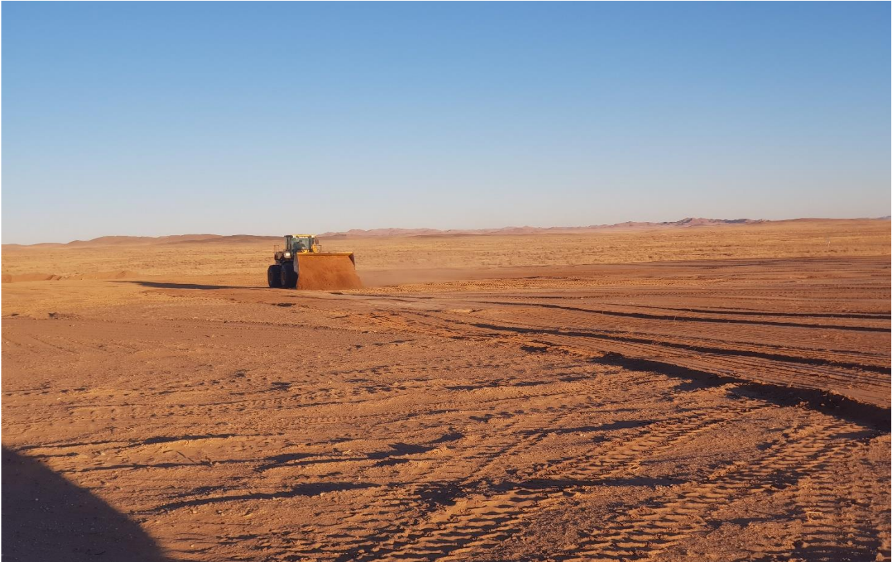
Зураг-5: В-1-с В-8 блокуудад техникийн нөхөн сэргээлт хийсний дараа шимт хөрсний хучилт хийх явц
