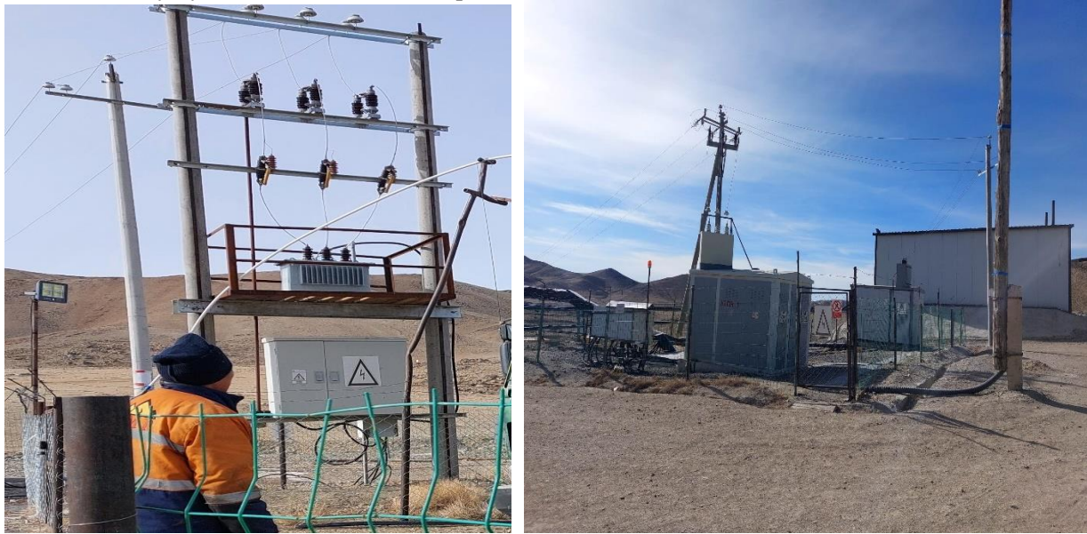
Зураг 13. Дэд станц
