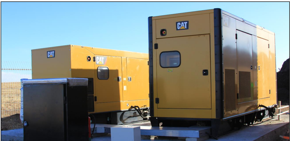
Зураг 5. Ажилчдын хотхоны цахилгаан эх үүсвэрийн дизель генератор
