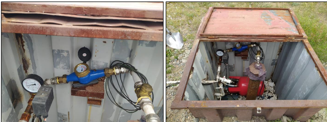
Зураг 16. Усны тоолуур суурилуулсан байдал, худгийг тохижуулсан байдал
