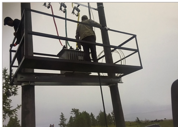
Зураг 14. Дэд станц
