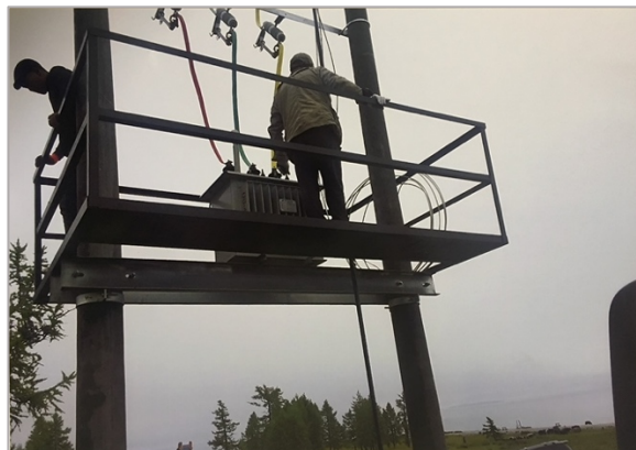
Зураг 14. Дэд станц
