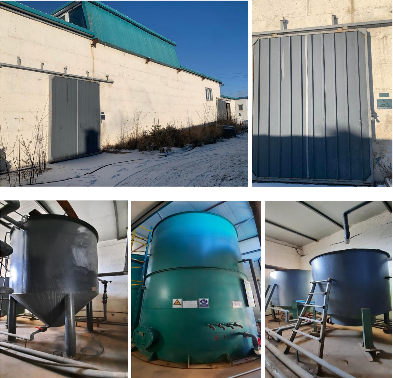
Зураг 14. Цэвэрлэх байгууламжийн байр, төхөөрөмж
