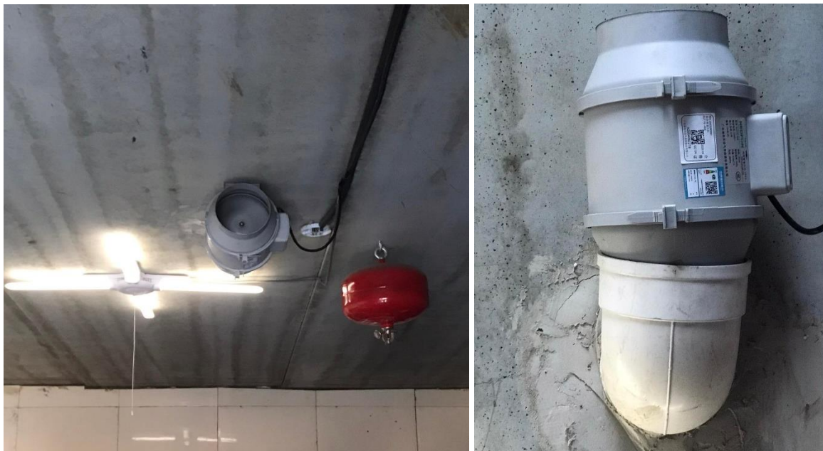
Зураг 9. Агуулахын өрөөний вентилиаторын фото зураг №6
