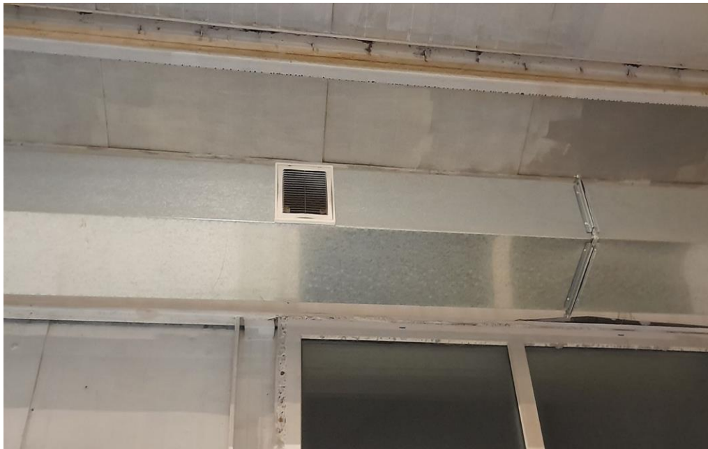
Зураг 24. Ариун цэврийн өрөөнд агааржуулагч сэнс байршуулсан фото зураг
