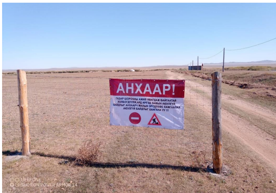
Зураг 14. Барилга, газар шорооны ажил хийгдэж буй талбаруудад хамгаалалтын бүс татаж, анхааруулах самбар байрлуулсан байдал
