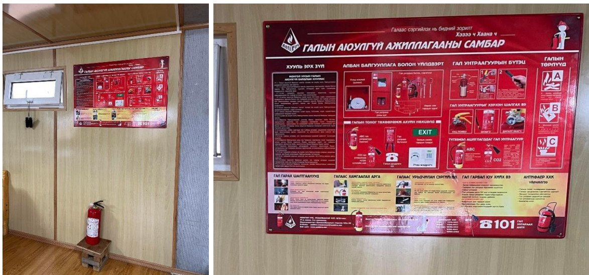
Зураг 33. Кемпед галын аюулгүй ажиллагааны зааварчилгаа бүхий самбар болон зөөврийн галын хор байршуулсан байдал
