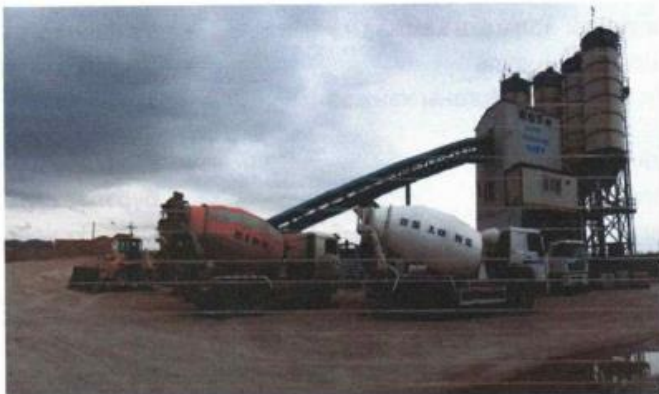
Зураг 25. Бэлэн болсон бетон зуурмагийг зориулалтын холигч тээврийн хэрэгсэлд юүлж буй байдал
