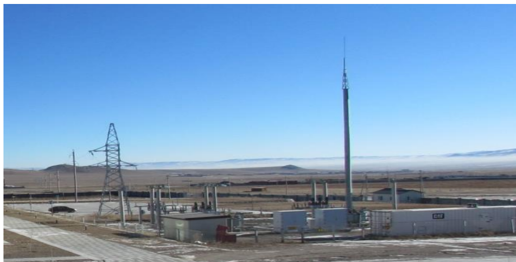
Зураг 3: Цахилгааны 35/0,4 кВ-ын дэд станц
